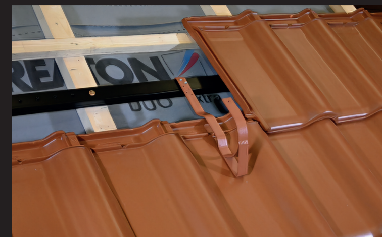
Cârlig de siguranță pe acoperiș
